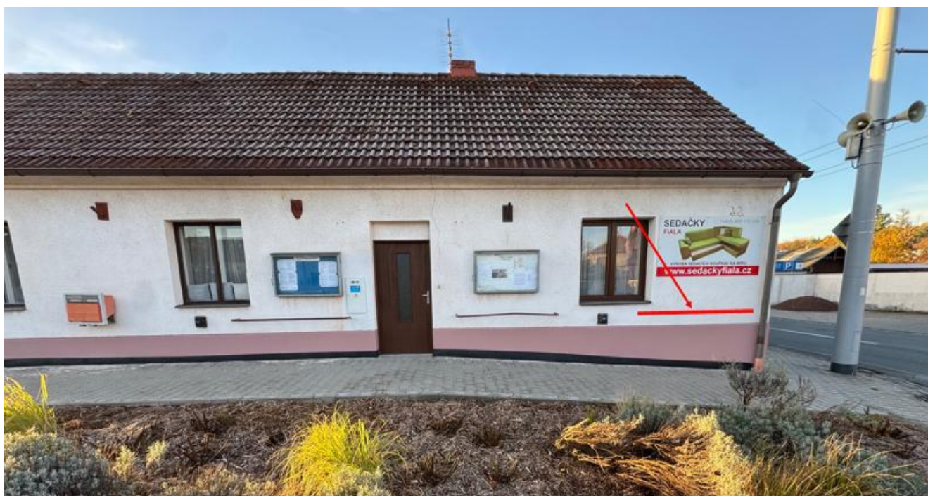
Obr. 1 (červeně znázorněn návrh na umístění zábradlí, které by zamezilo pádu na kluzkém povrchu svažitého chodníku)
