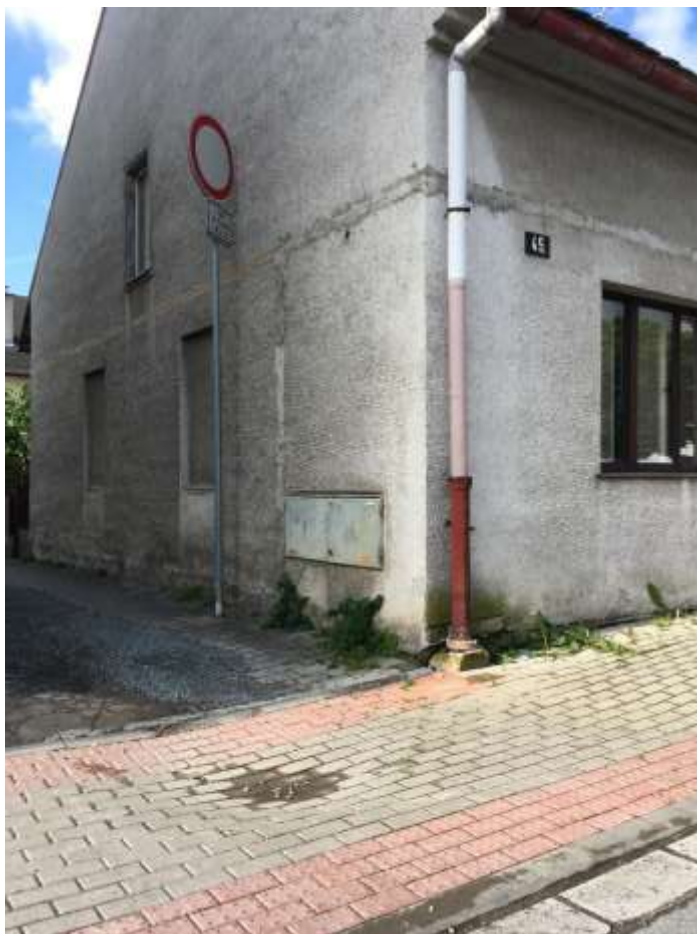
Fotky k bodu 2) C – propadlý chodník v ul. Na Záběří před č.p. 45 a 25
