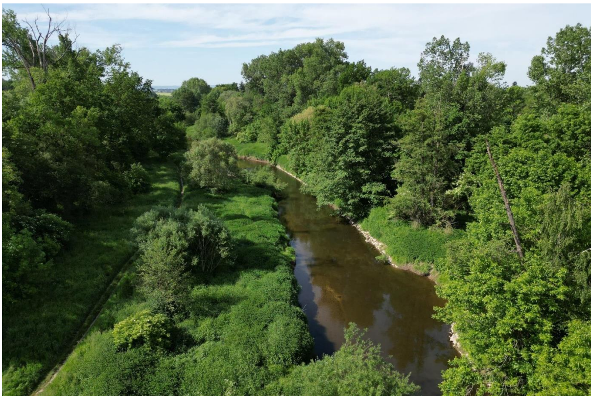
Obr. Pohled od Zeleňáku na levobřežní bermu s vyšlapanou stezkou a pomístně narušenou linií opevnění kynety.
