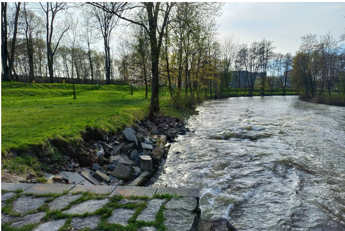
Obr. Chrudimka, její levobřežní berma a těleso protipovodňové hráze pod jezem, patrně je narušené opevnění břehu.
