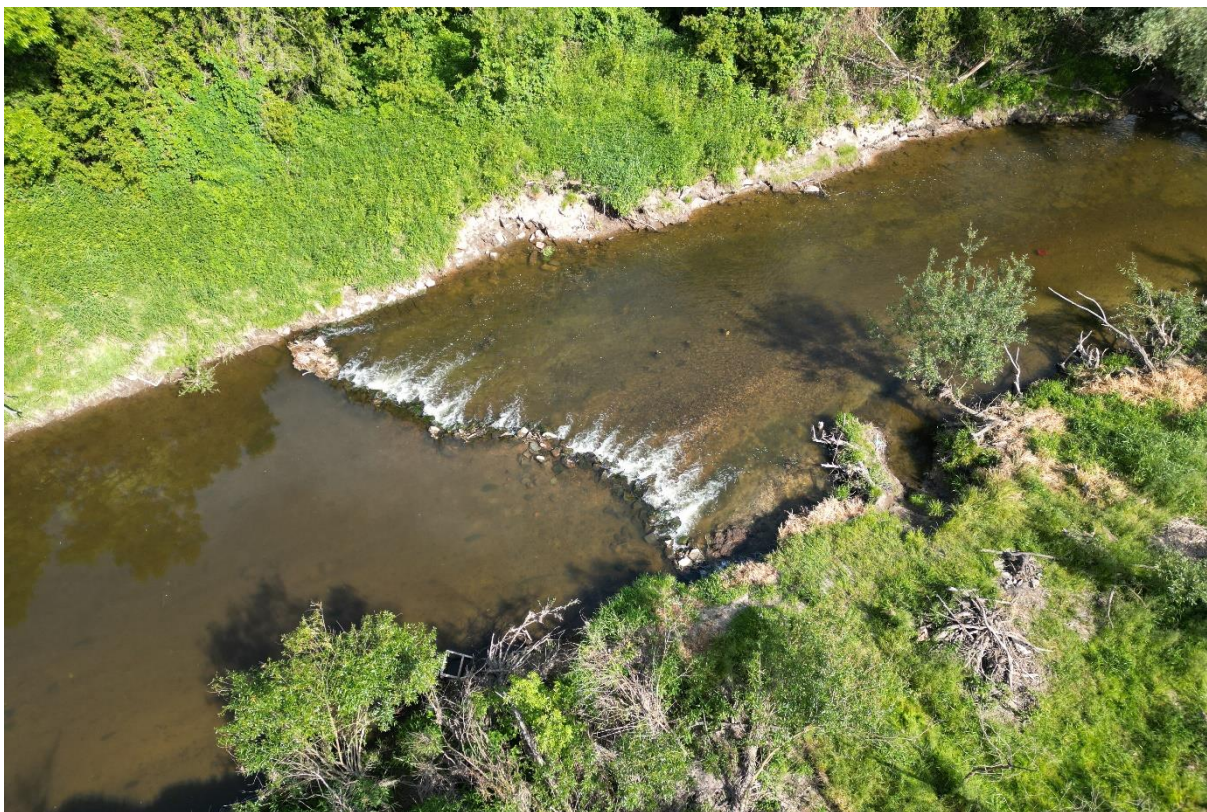
Obr. Současný stav koryta u mostu Zeleňák, je patrná linie upravené kynety s opevněním, narušeným břehovou nátrží.
